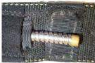
Putki irronnut, täkkäys puuttuu
