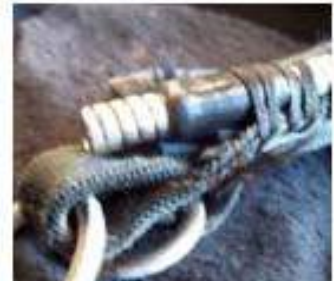
Putken pää tullut läpi suoja- muovista
